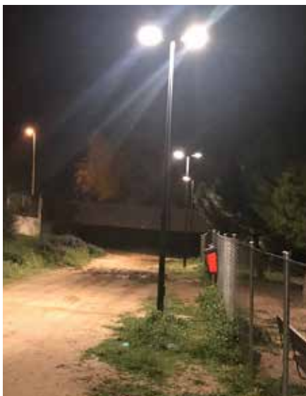
En este caso se han reutilizado existentes, instalándolas al lazo del ZOC.
